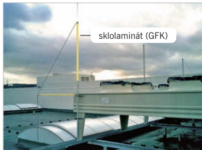
Instalácia oddialeného bleskozvodu pomocou izolačných podpier.
